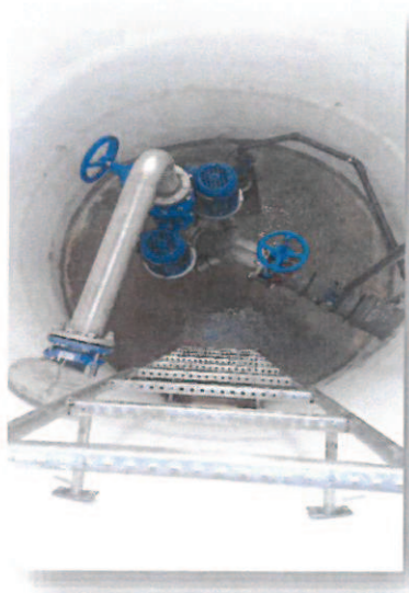
Bombagem em linha – EE Rio de Cima
