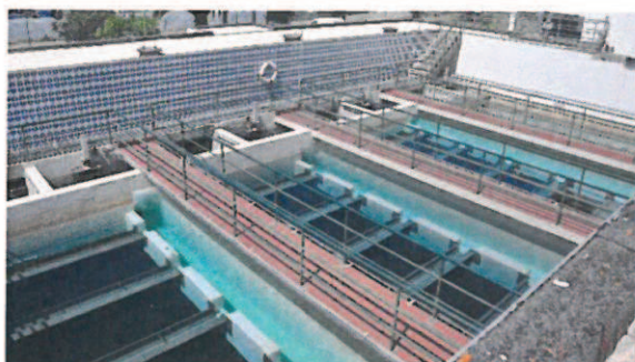
ETA de Vila Verde (Filtros de CAG)
