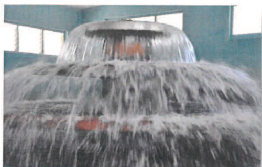
ETA de Carritos (Cascata de Arejamento)
