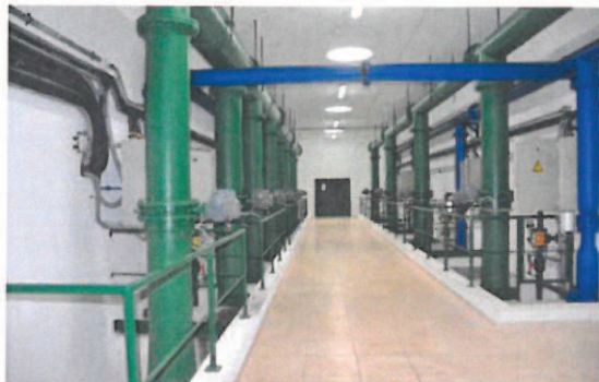
ETA de Vila Verde (Galeria dos Filtros)
