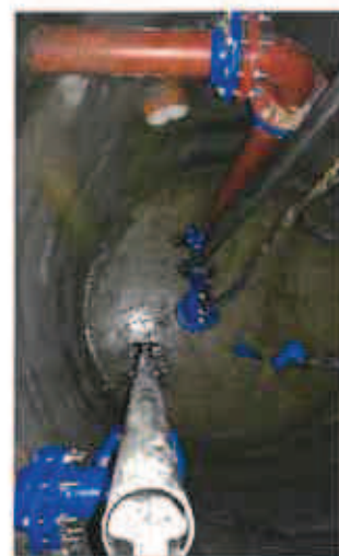
Bombagem em linha – EE da Rua da Caneira
