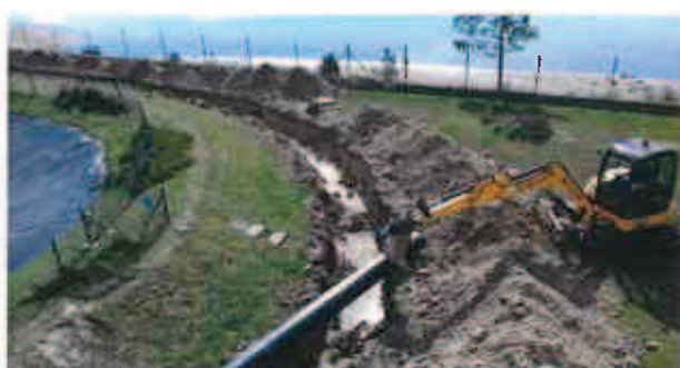
ETAR Urbana – Desvio à lagoa do efluente tratado
