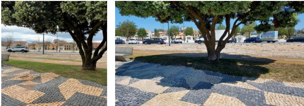
Av. a Infante D. Pedro - Correção de calçada devido às raízes das árvores, Buarcos (antes e depois)
